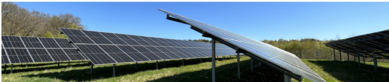
På bilden syns en typisk markmonterad solpark där varje rad består av två ovanpå varandra stående solpaneler, så kallade poträttorienterade solpaneler. Foto: Lars André
