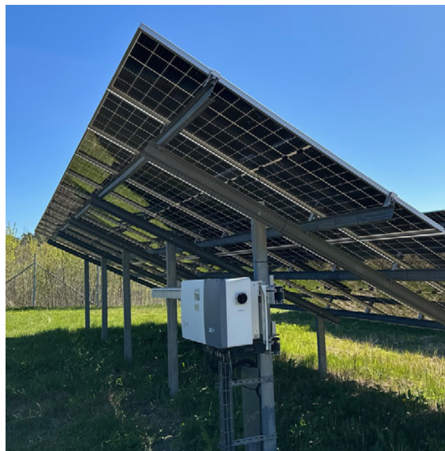
Bilden visar dubbelsidiga glas/glas laminerade solpaneler med växelriktaren placerad under panelerna. En glas/glas konstruktion har i allmänhet längre garantitid. Dubbelverkande solpaneler kan ta vara på reflektion från marken, speciellt intressant är detta när marken är täckt med snö. Foto: Lars Andrén
