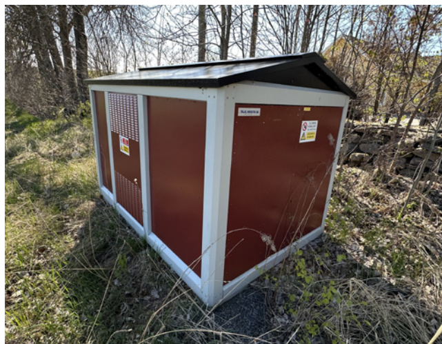
Närheten till en nätanslutning och tillgång till en transformatorstation kan vara en avgörande faktor för projektets genomförande och lönsamhet. Foto: Lars Andrén
