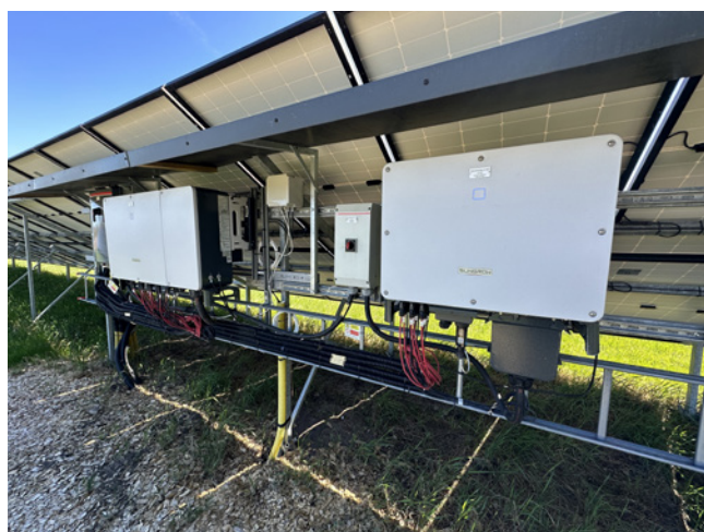
Bilden visar växelriktare och säkerhetsbrytare, monterade under solpanelerna. OBS att kablagen och växelriktaren på bilden inte är skyddade för att kunna ha betesdjur i solparken. Foto: Lars Andrén
